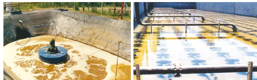
Aireadores mecánicos superficiales
